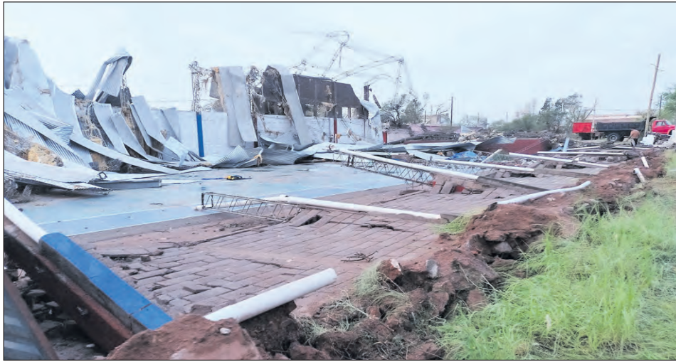
Fotografía archivo de los daños ocasionados por el temporal en febrero del 2025.
