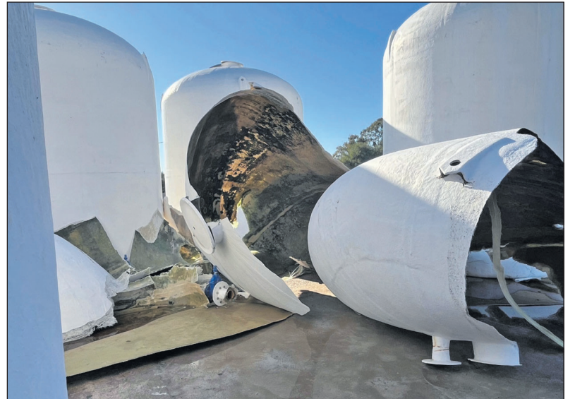
Así quedaron los tanques de Pozo San Carlos tras la explosión.
