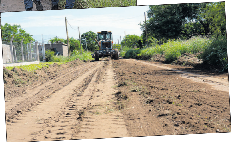
Operarios municipales realizan trabajos de reacondicionamiento de calles en uno de los barrios.
